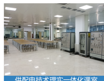
供配电技术理实一体化课室
